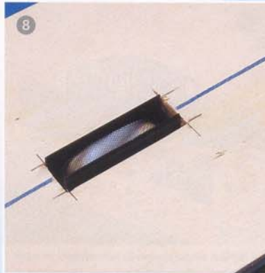
An der Plattenoberseite muss der Magnet mit der Schienenoberkante abschließen. In dieser Position wirkt er optimal auf die Wagenkupplungen. Unterseitig erreicht der Magnet einen „Tiefgang“ von etwa 20 mm.
