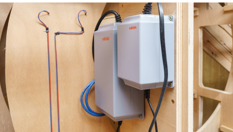
Kraftwerk: Die Schaltnetzteile für die Central Station und die Beleuchtung finden an einem Querspann bequemen Platz.
