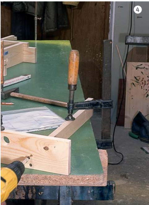
Wie in Abb. 3 dargestellt werden hier zwei Innenstreben miteinander verschraubt. Ein Teil der schon verbundenen Innenstreben liegt im Hintergrund. Teils sind schon die Bohrlöcher zur späteren Kabeldurchführung angebracht.
